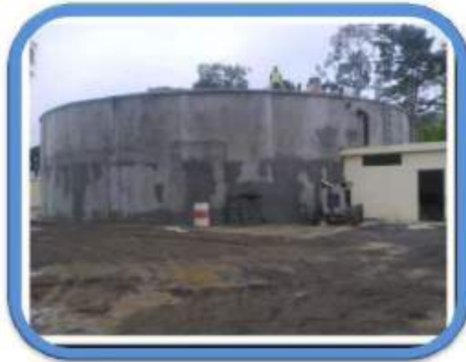
Foto: Tanque bajo de la Estación de Bombeo # 2
