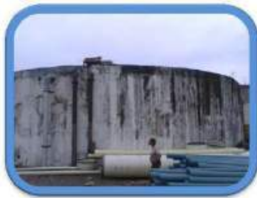
Foto: Tanque bajo de la Estación de Bombeo # 1
